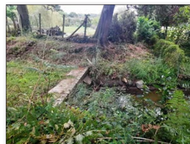
Le Calais, à l'endroit où il s'écoule sous la dalle, dans la buse.
